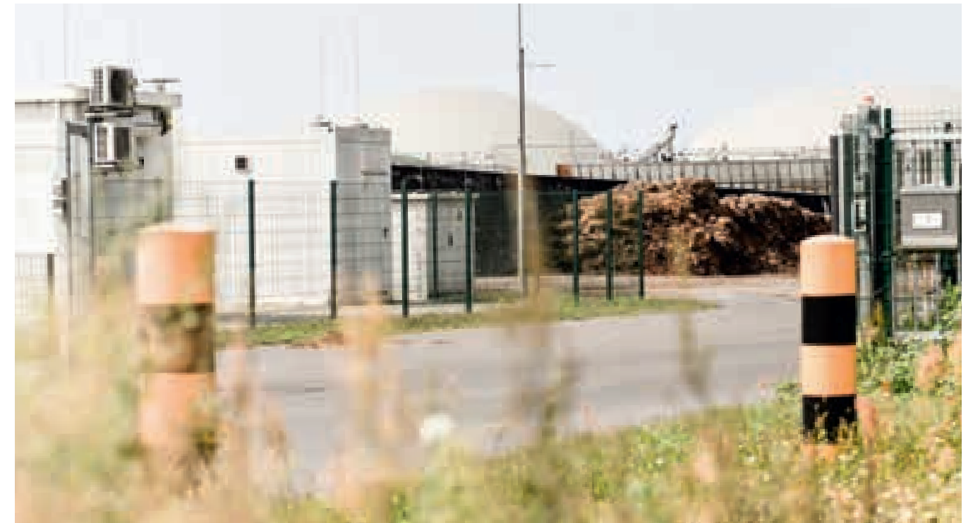
Die Erneuerbaren – wie hier die Biogasanlage – sind zur wichtigen Einnahmequelle geworden.
